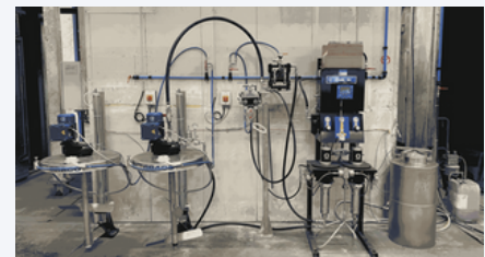
D'installations complètes sur site
